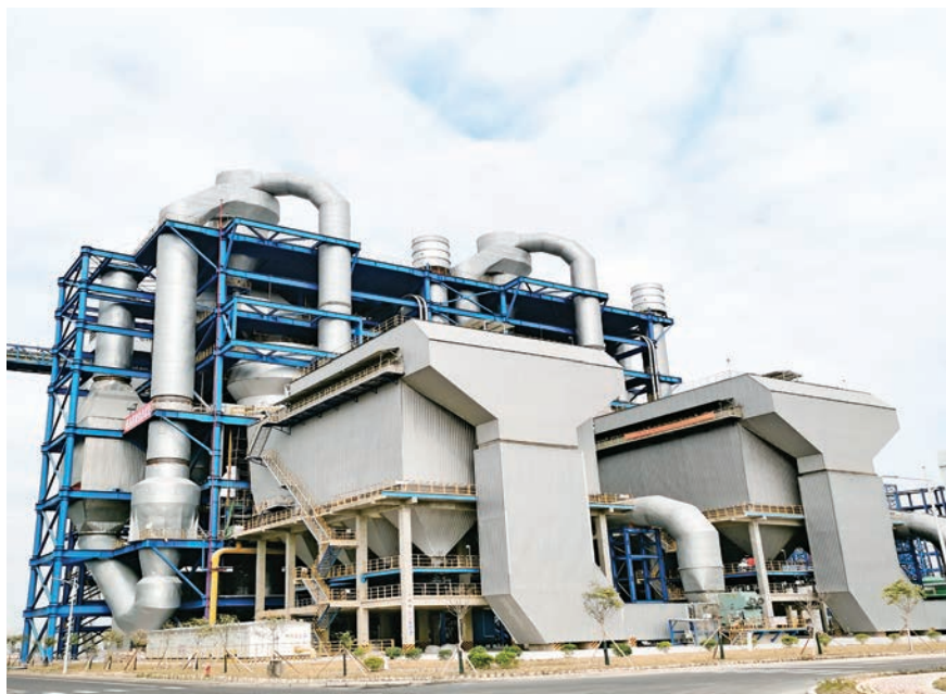
大型高效氧化铝气态悬浮焙烧炉
