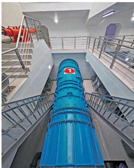
永磁电机产品安装应用现场
