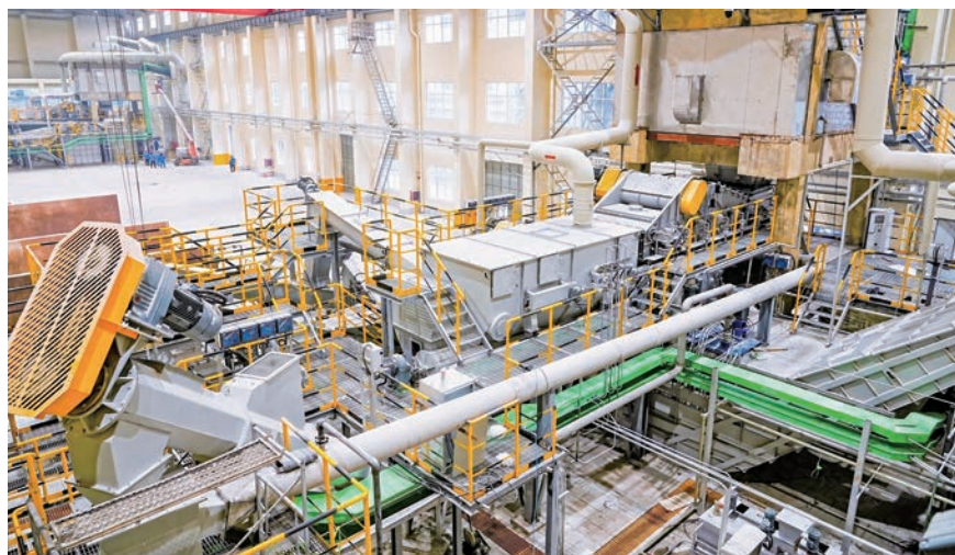
自主设计制造的废铅酸蓄电池自动处理系统
