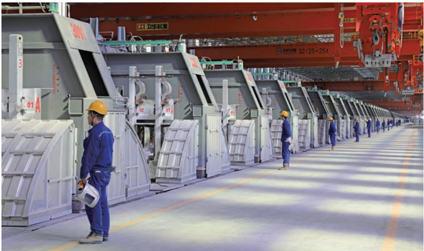
职工检视电解槽
