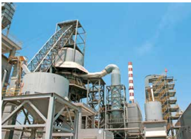
回转窑烟气除尘脱硝系统
