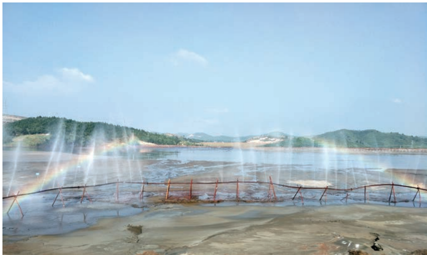
尾矿库防扬尘喷淋系统
